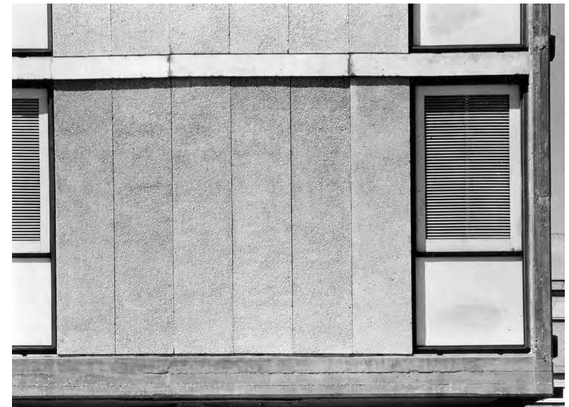
פרט קיר פריקסט עם גמר גרנוליט וחלונות עד גובה התקרה לאורזר הדירה
